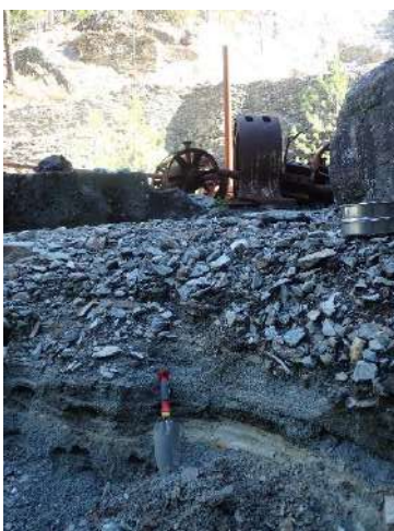
Bassin avec résidus de traitement de la laverie récente (2B_0003_A_T3) sapé par la Finosa
