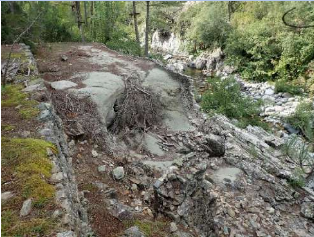
Bassin avec résidus de traitement de l'ancienne laverie (2B_0003_A_T8) sapé par le Fium'Orbu
