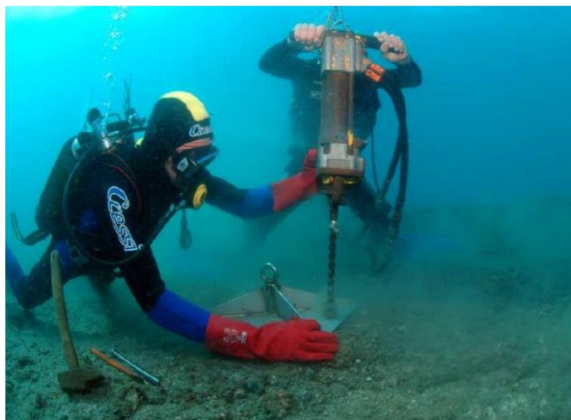
Figure 9 : Perçage de la roche avec perforateur hydraulique pour scellement des tirants (Neptune Environnement)
