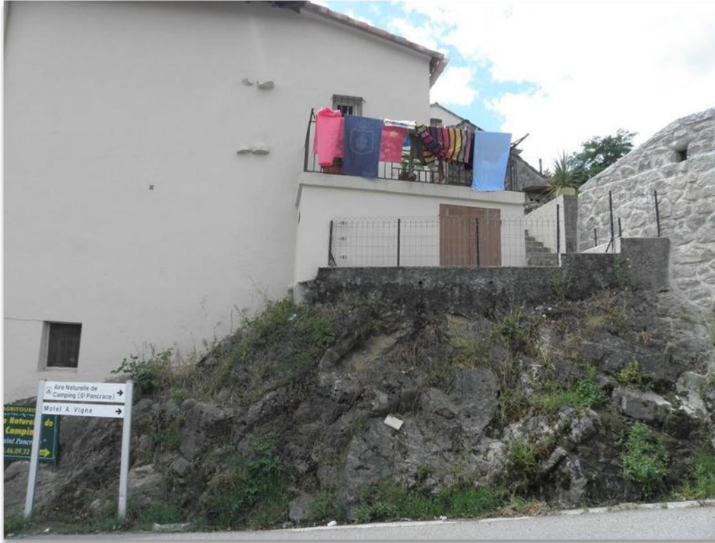
Illustration 15 : Talus de serpentinites à plans de glissement amiantifères (site 2BFC099).
