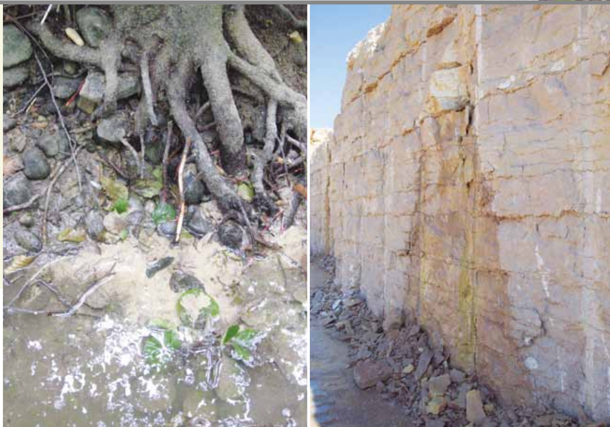
Figure 10 : suintements d'eau souterraine dans les berges d'un ruisseau (à gauche), venue d'eau dans le front de taille à l'intersection d'une fracture Nord 20° et d'un plan de stratification (à droite) - Source : Cerema/DTerCE.
