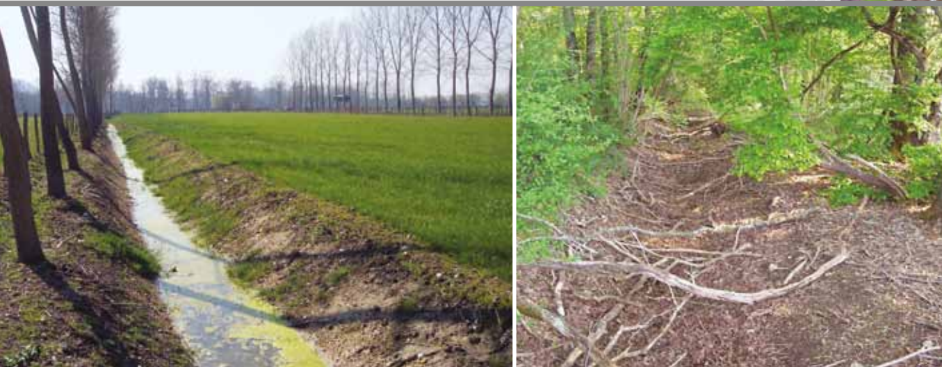
Figure 6 : état des fossés de drainage superficiel, en eau (à gauche) ou à sec (à droite) - Source : Cerema/DTerCE.
