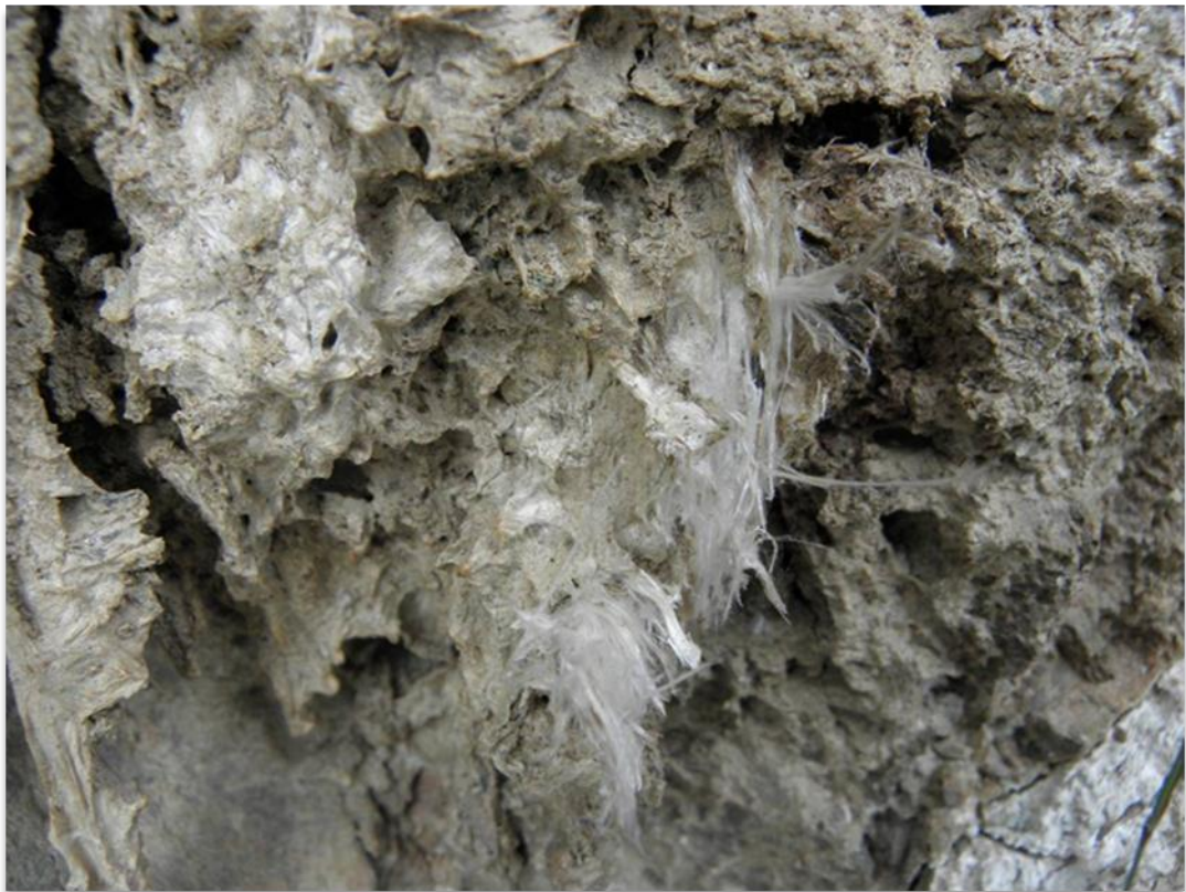
Illustration 16 : Amas de fibres amiantifères de trémolite (talus de la D39 – site 2BFC075).
