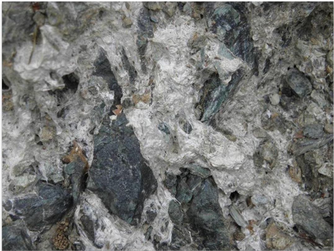
Illustration 20 : Amas de (micro)fibres amiantifères dans le talus routier (2BFC075).
