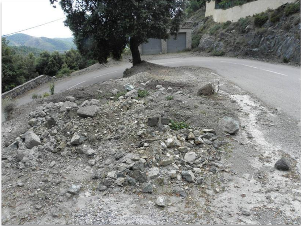
Illustration 19 : Déblais amiantifères dans un virage et talus routier amiantifère (2BFC075).
