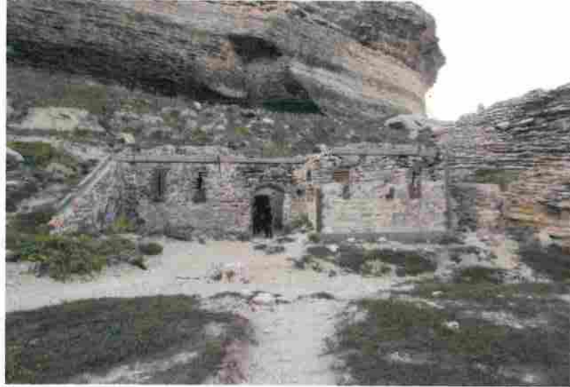
La façade principale très dégradée.
