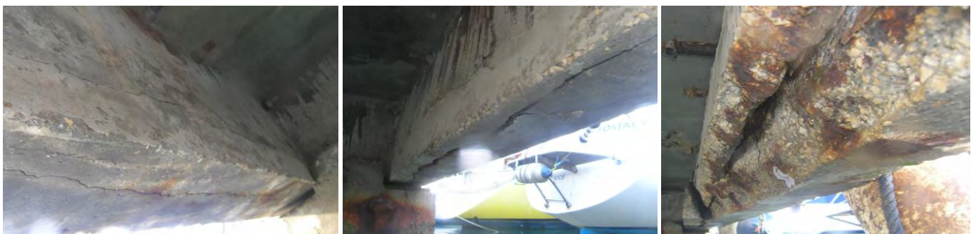
Figure 5 : Dégradations des poutres à différents degrés d'avancement
