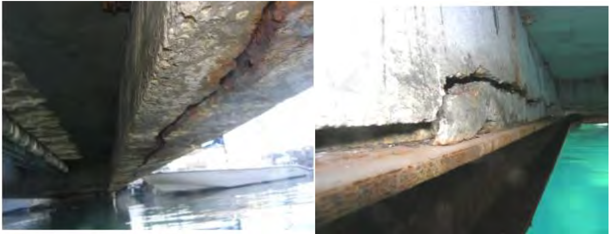
Figure 6 : Eclatement du béton et détachement de la partie basse de la poutre retenue par un profilé métallique en renfort à droite
