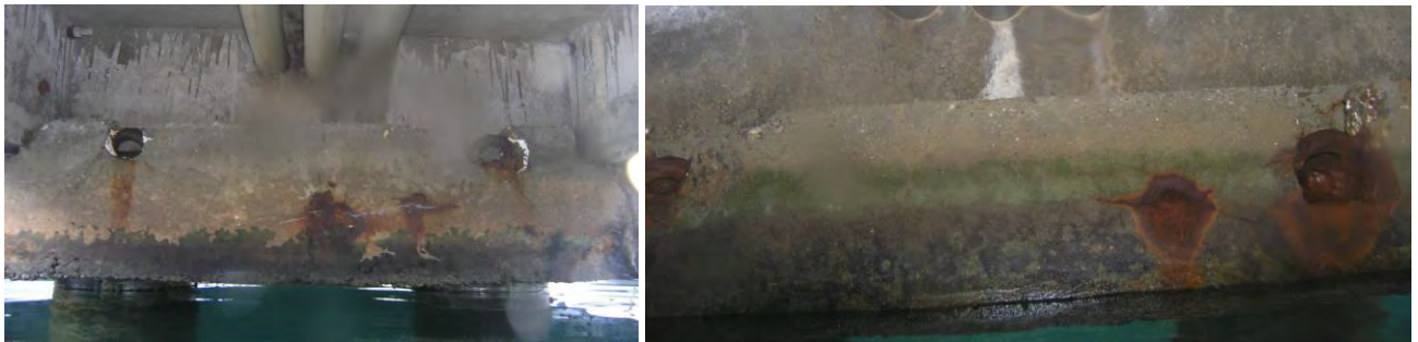
Figure 7 : Dégradations des bétons observées sur les Chevêtres
