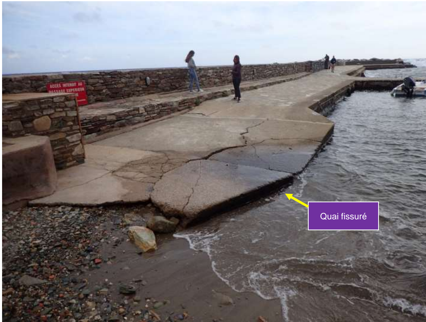
Figure 4. Photo 2, quai bétonné avec fissures – ICTP Octobre 2020
