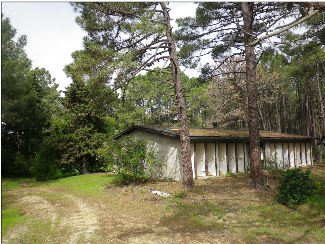
Figure 65. Bâtiment des sanitaires en ruine du village de vacance actuel
