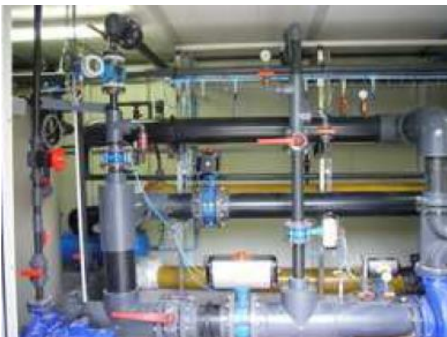
UF et évapoconcentration du digestat – Geotexia (22)
