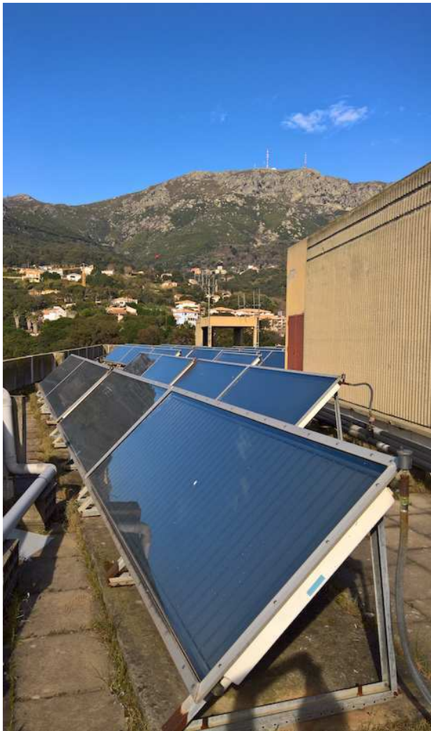
Panneaux solaires thermiques installés sur le toit du Centre Hospitalier de Bastia
