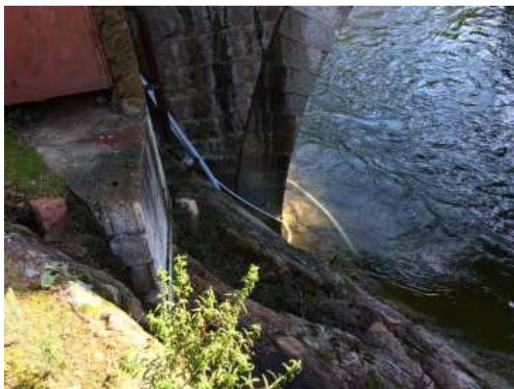
Figure 19 : Prise de secours du PORTO. Crépine et tuyaux à enlever.
