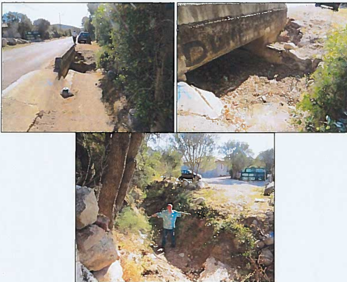
Fig. 7 – Collecte des eaux pluviales
