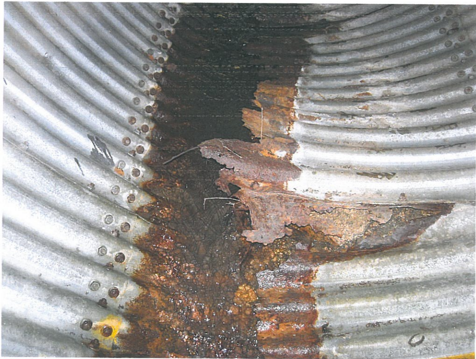
Dégradation du radier (08/02/2010)
