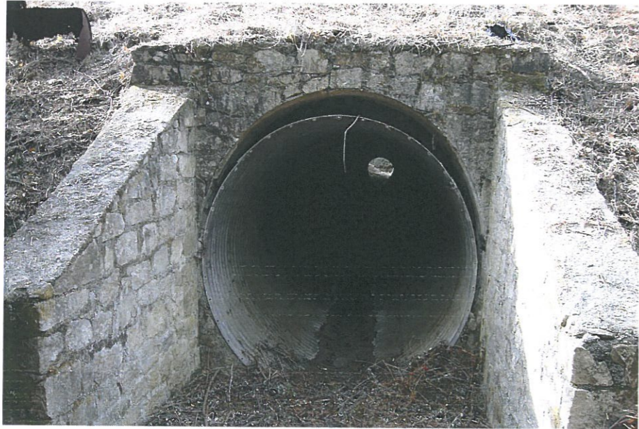
Déformation de la tête amont de l'ouvrage (22/10/2010)
