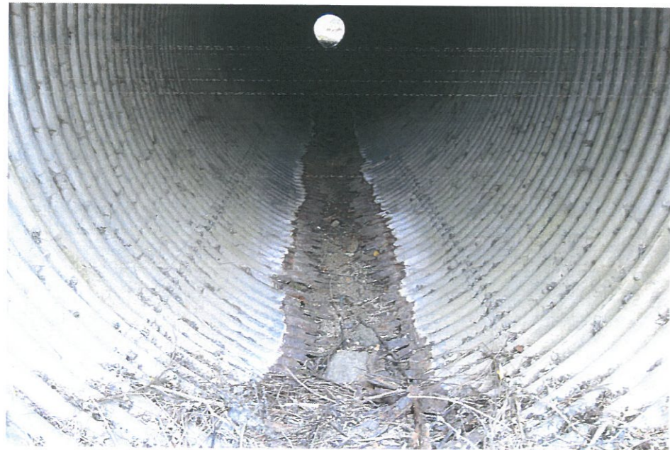
Corrosion très avancée du radier avec perte de matière (22/10/2010)
